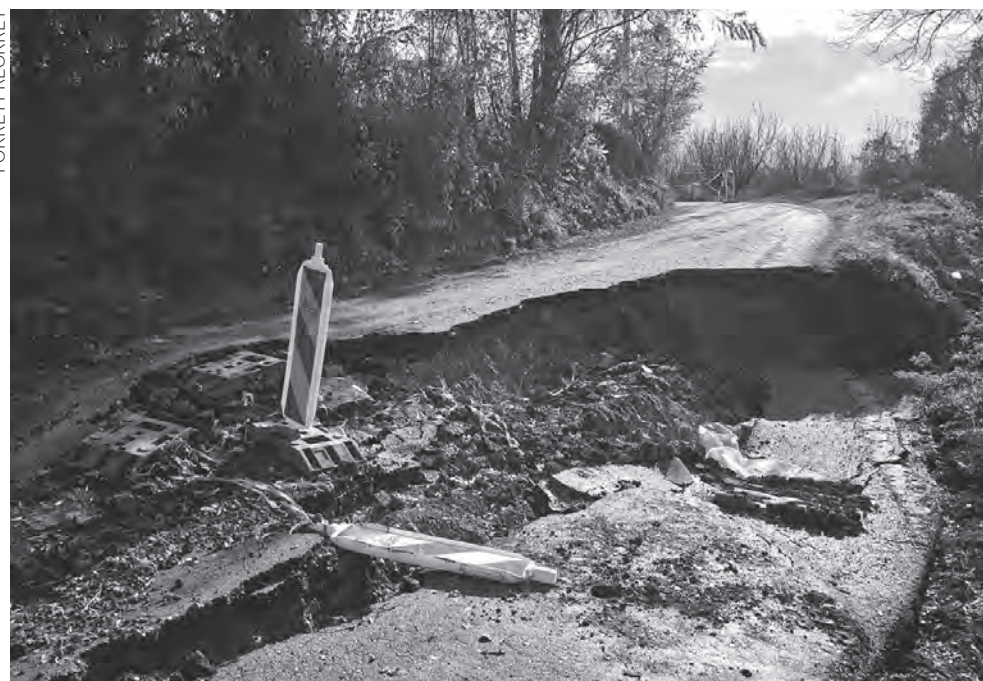
KIŠA DODATNO OŠTETILA PUT: Klizište na putu preko Pričelja
